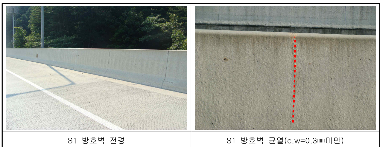
【사진 3.12】 방호벽 손상 현황
